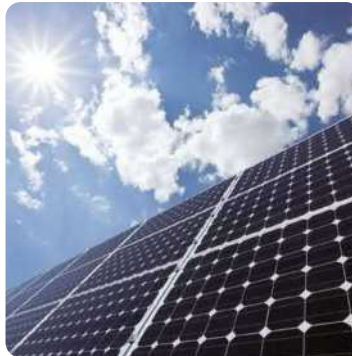
Energiegewinnung durch Photovoltaik bei EVVA
